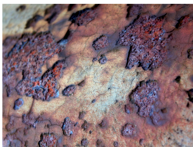
Trozo de metal oxidado (corroído)
