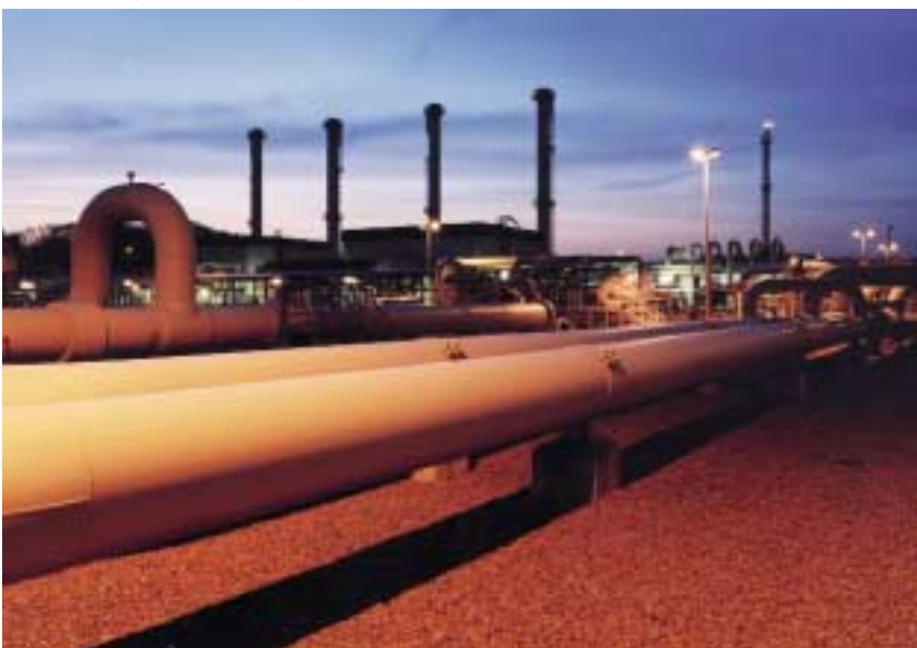
Größter europäischer Erdgasspeicher
