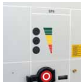
Dispositivo de control SF6 con tres LED.
