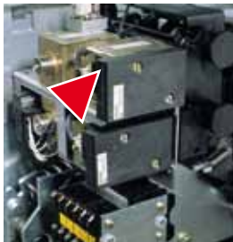
Relé de mínima tensión.
